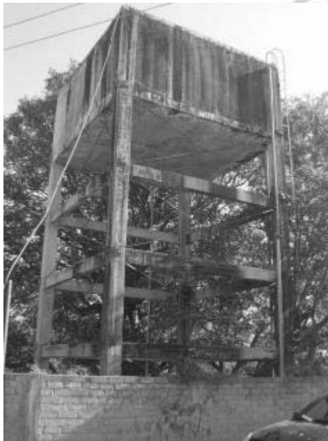
TANQUE DE ALMACENAMIENTO DE AGUA
