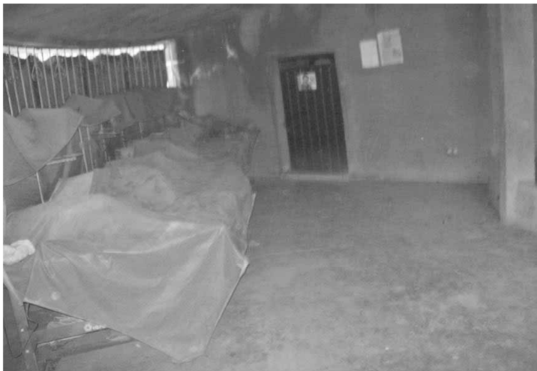
Anexo 6: Infraestructura Productiva en mal estado.
