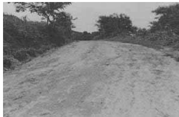
Figura 38: Terracerías en mal estado con muchos baches
