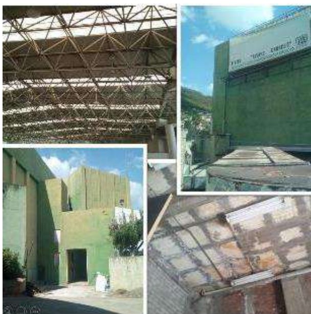
Figura 1. Situación del Teatro Álvaro Carrillo previo a demolición
